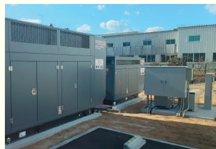
災害時でも電力供給できる ガス発電システムを導入
